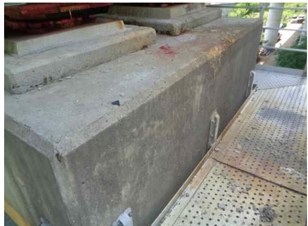
손상현황 • P7 표면오염(3.0×3.0) 원 인 • 하부누수, 우수유입 등 조치방안 • 주의관찰
