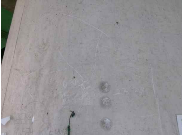
손상현황 • P1 망상균열(2.5×3.0) 원 인 • 건조수축, 온도변화 등 조치방안 • 표면처리
