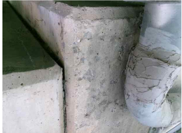
손상현황 • P2 박리(1.0×1.0) 원 인 • 시공미흡, 우수유입 등 조치방안 • 단면보수
