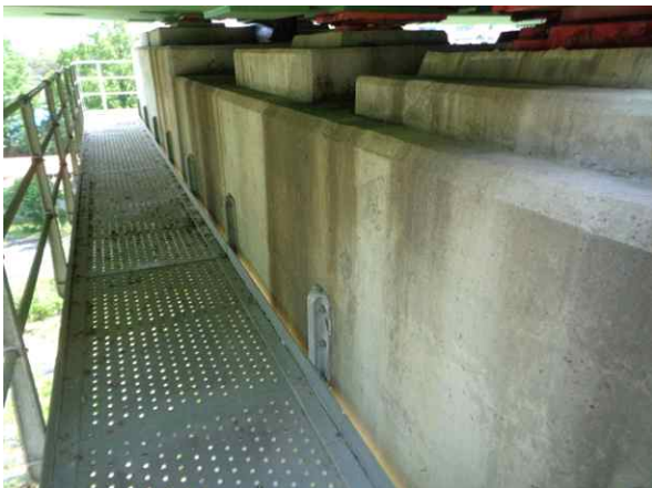
손상현황 • P7 누수흔적(3.0×5.0) 원 인 • 하부누수, 우수유입 등 조치방안 • 주의관찰
